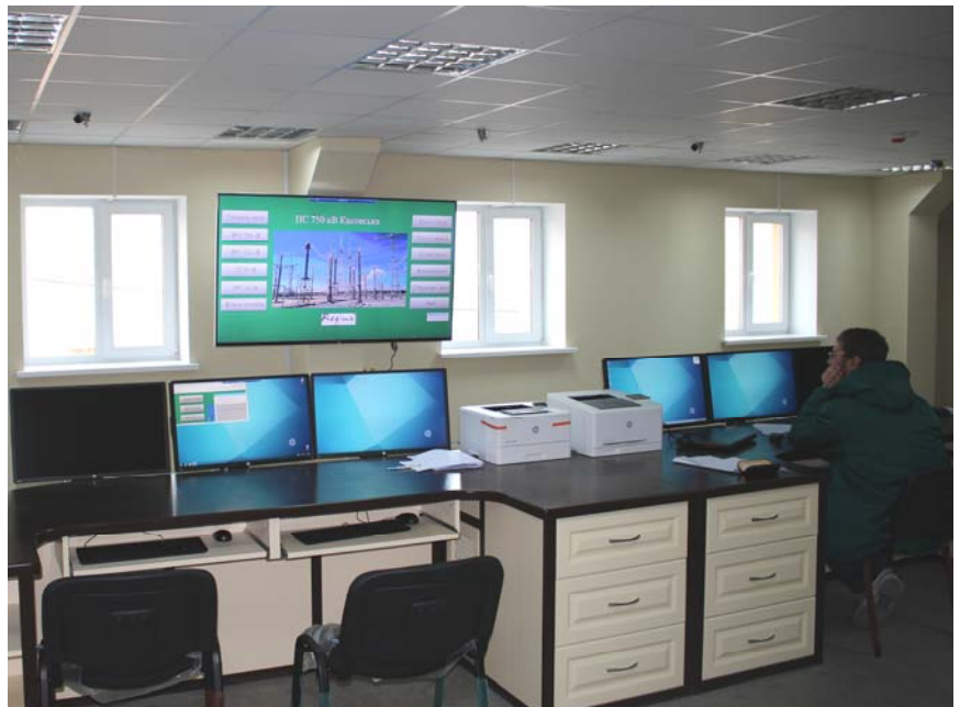
Зал керування підстанції 750 кВ "Каховська"
